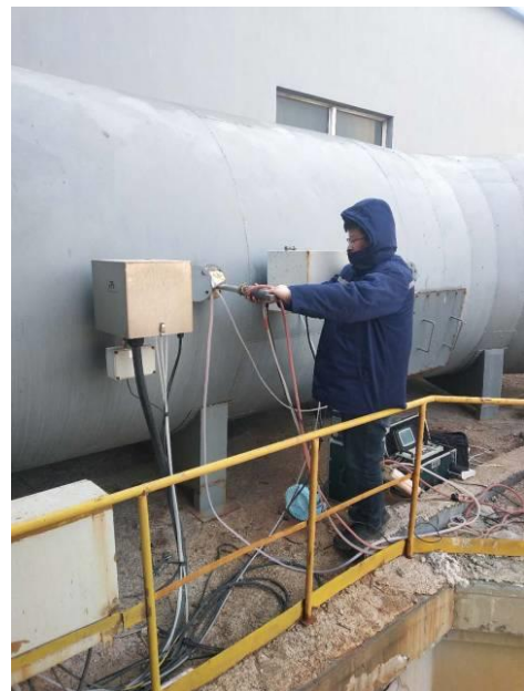
锅炉装置净化器后口
