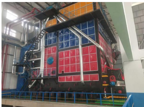
新建 100t/h 燃煤锅炉
