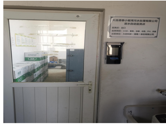
出水在线监测站
