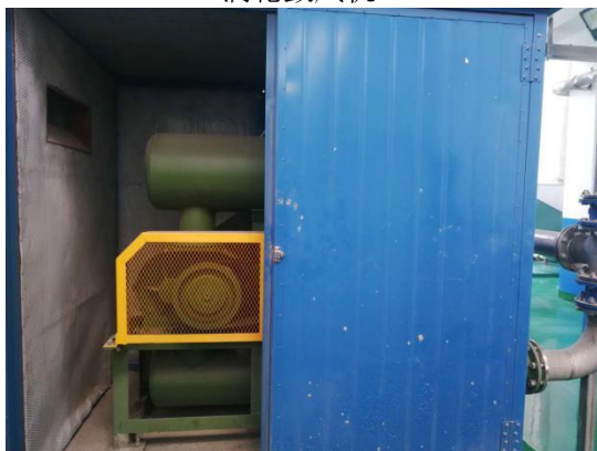
曝气沉砂池风机
