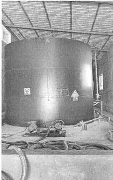
油罐区及导油泵
